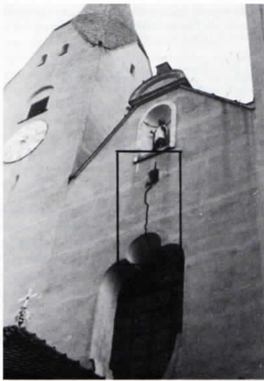
Mauerriß am Westwerk der Klosterkirche Indersdorf. Aus dem Gutachten des Herrn Dr. Brannekämper vom 21. März 1969.
