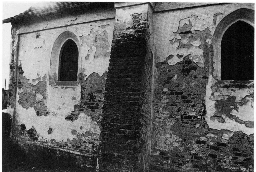
Südwand der Kapelle in Rudersberg vor der Renovie- rung mit teilweise vermauer- ten Fenstern und angesetztem Stützpfeiler.
