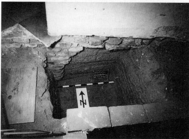
Abb. 6: Altomünster, Sondage 11. Romanisches Apsisfundament (rechts) mit tiefreichend angestücktem Fundament des 18. Jahrhunderts (links) von Süden.
